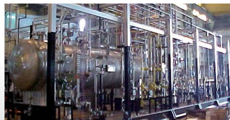
Unidad de Tratamiento de Sodas Agotadas
